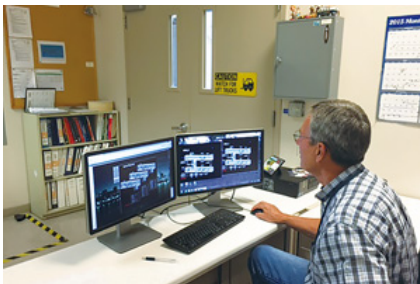
モニター画面で空調の稼働状況を確認
