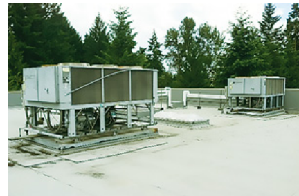
屋上に設置されている空調設備
