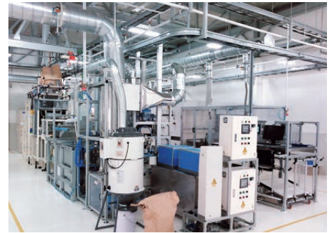
吸収材の生産装置
