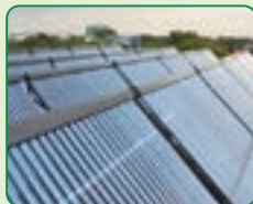
太陽光パネル
