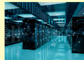
データセンター
