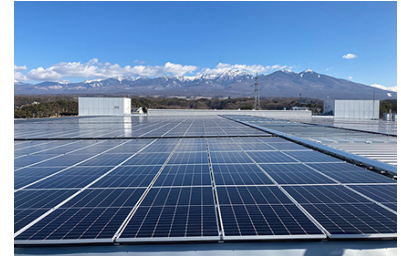
Japan (Fujimi Plant): PPA 1
